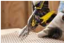
Malla de acero
