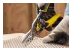
Malla de acero
